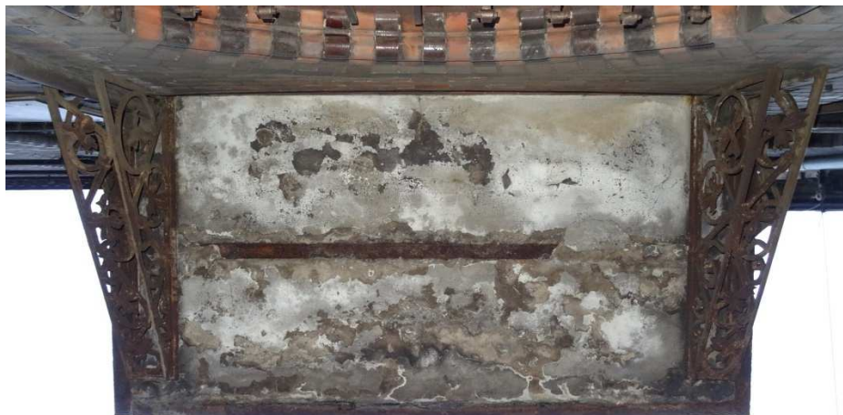
Fot. nr 2 Widok uszkodzeń płyty balkonowej
