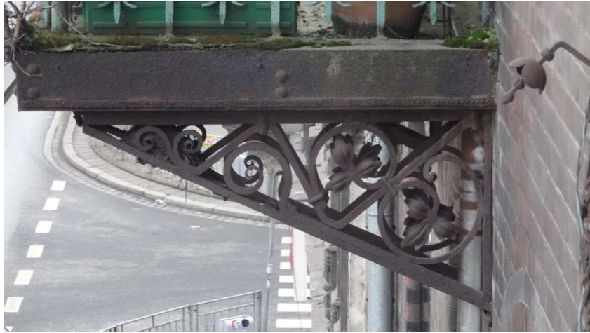
Fot. nr 4 Belka i wspornik balkonu.
