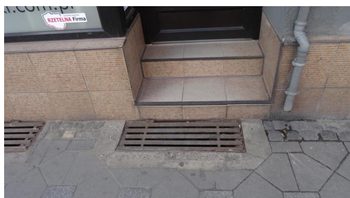
Fot. Biuro Obsługi Budownictwa, nawierzchnia od strony elewacji frontowej- płytki gresowe do skucia
