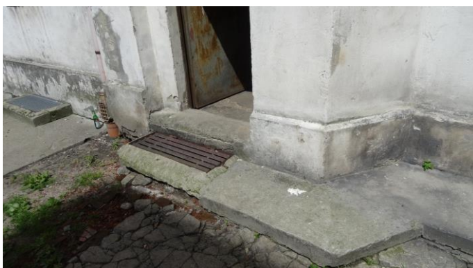
Fot. Biuro Obsługi Budownictwa, nawierzchnia od strony elewacji podwórzowej
